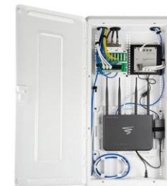
Armoires innovantes de distribution des flux électriques et numériques On-Q Amérique du Nord
