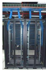
Cheminement de câbles
