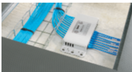
Chemin de câbles en fil Cablofil et boîte de distribution de zone
