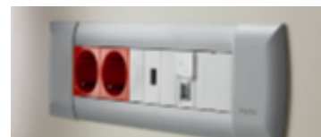
Blocs de bureau encastrés
