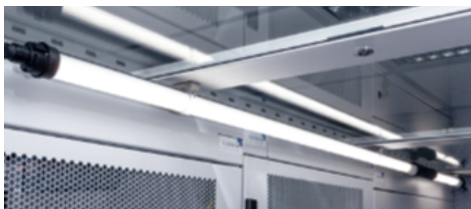
Éclairage à LED
