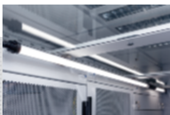
1 Éclairage à LED → VOIR P. 65
